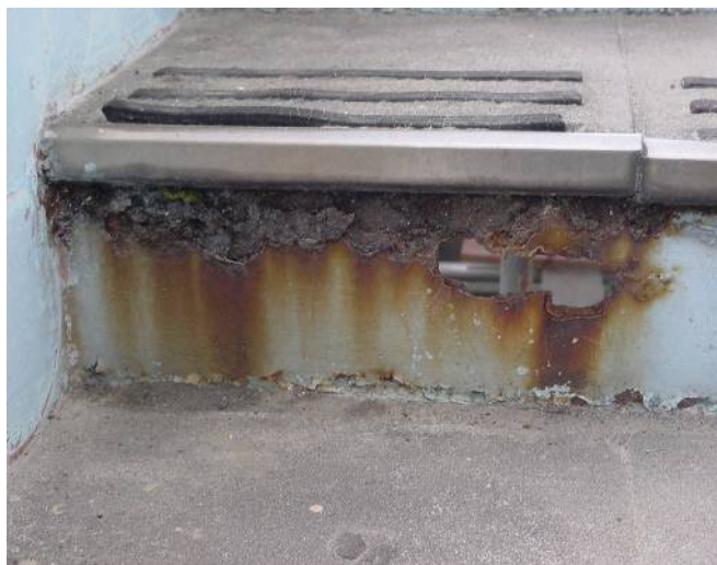
現状腐食状況
