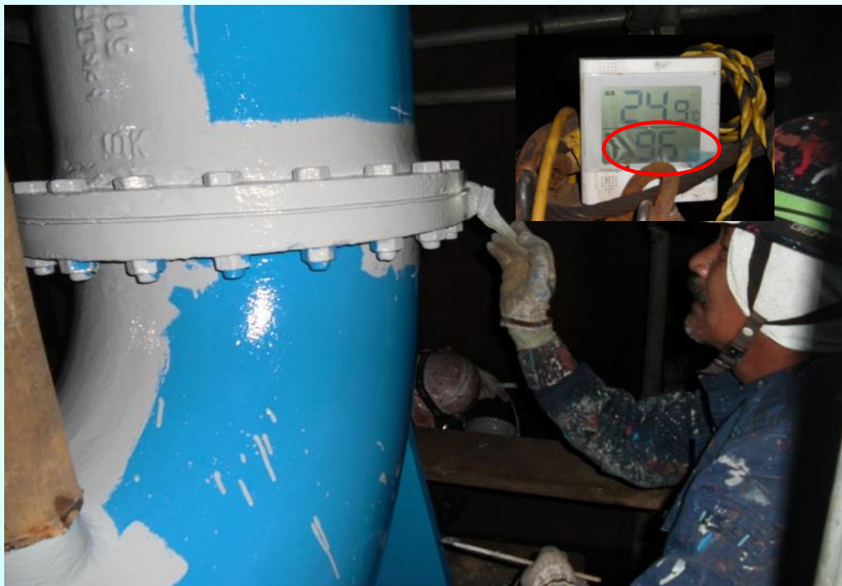
地下ポンプ室内 配管
