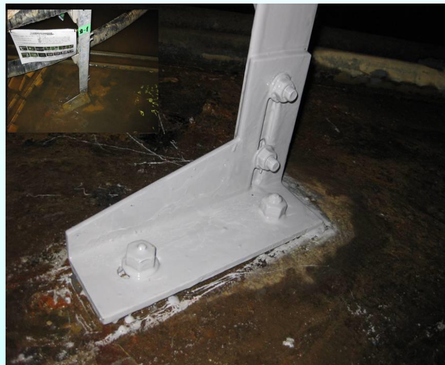
地下洞道内架台 水浸漬部
