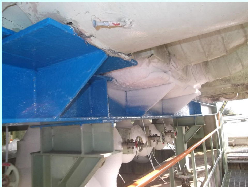
LNG配管架台
