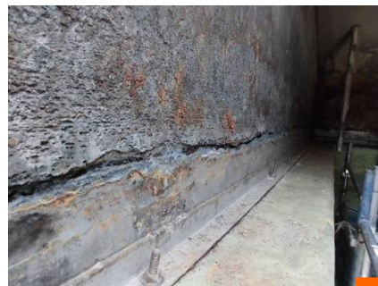
タンク内面孔食部(施工前)
