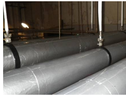
消火配管(施工後)
